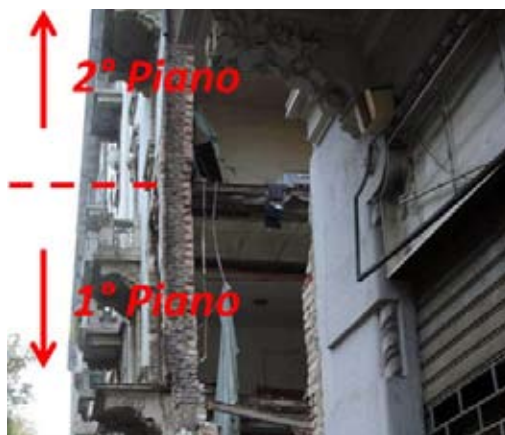
Facciata del 1° piano deformata verso l'esterno - zona di maggiore deformazione collocata tra il primo e il secondo piano
