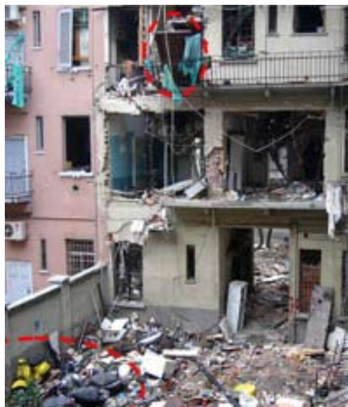
Facciata dell'edificio lato cortile - le onde di pressione generate dall'esplosione hanno spinto le porte verso l'esterno e i motorini uno contro l'altro
