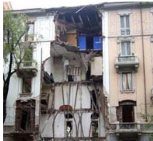
Facciata dell'edificio lato strada - zona maggiormente danneggiata dall'esplosione
