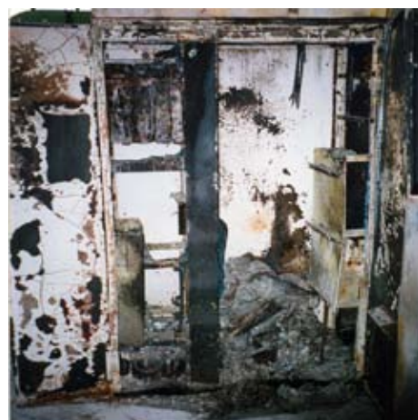
Armadio elettrico - si nota come l'esterno delle lamiere presenti bruciature particolarmente estese
