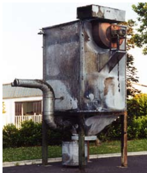
Impianto di trattamento dell'aria - è evidente come il componente sia stato rimosso dalla sua posizione originale
